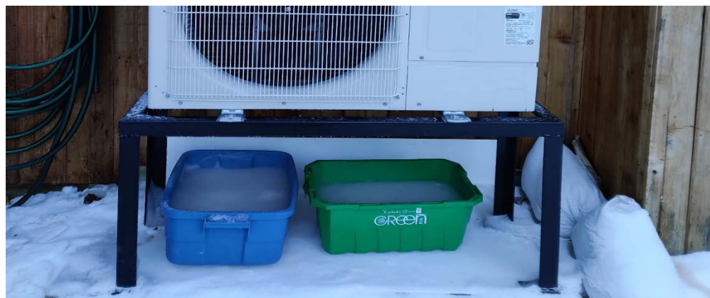
Figure 3 : Solution de gestion de l'eau du dégivrage sous l'unité extérieure Zuba (42 000 BTU/h) de Mitsubishi, avec bacs et sacs de sable posés sous l'unité et à côté.
