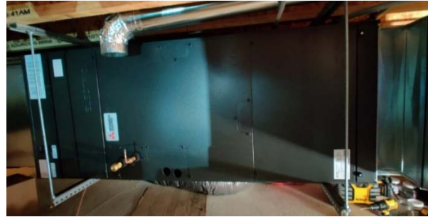
Figure 2 : Unité intérieure Zuba de Mitsubishi (36 000 BTU/h) à l'horizontale dans un vide sanitaire
