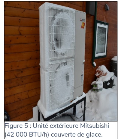
Figure 4 : Givre sur les pales d'une unité extérieure Mitsubishi (42 000 BTU/h).
