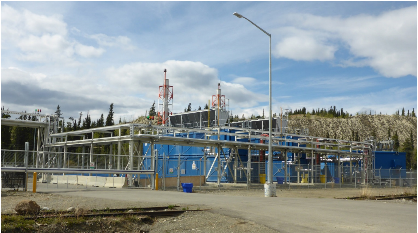
Centrale électrique de la SEY au gaz naturel liquéfié
